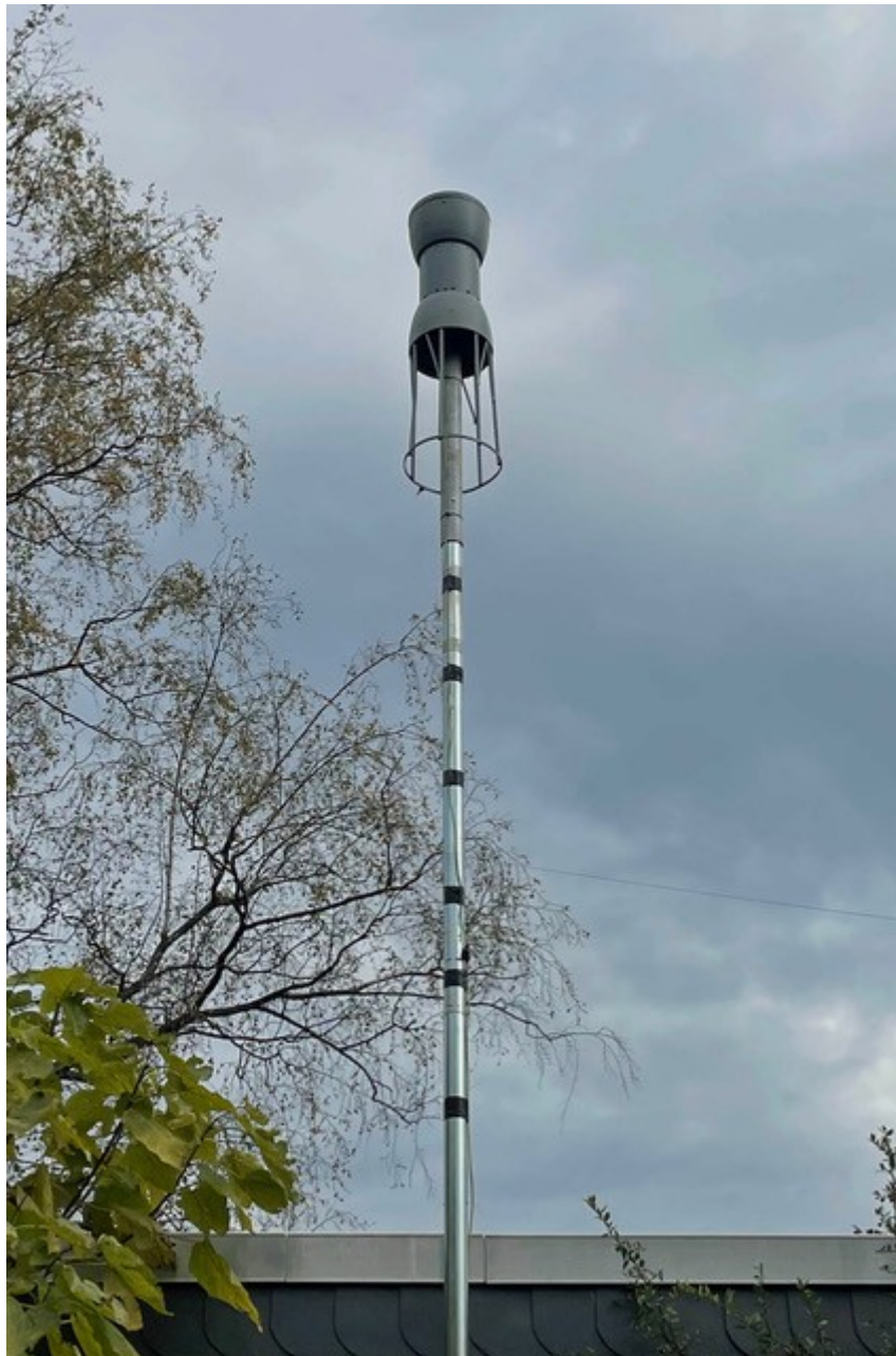
Die Antenne auf einem 5m Mast
